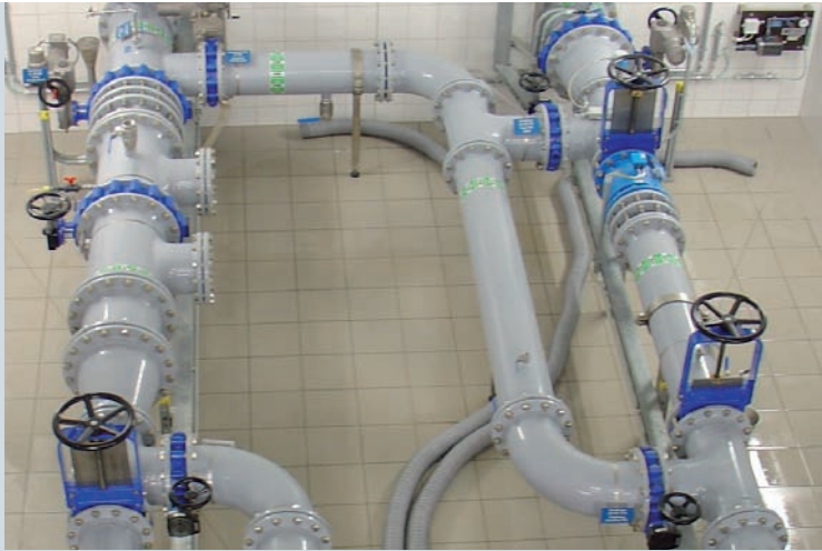
BILD 8: Polyamidbeschichtete Rohre in einer Schieberstation für Trinkwasser
